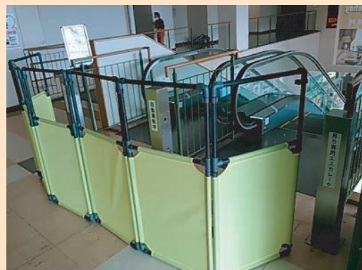
【エレベーター・エスカレーター保守点検安全柵】
